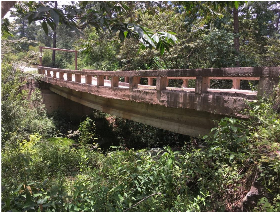
Vista de la sección lateral del puente, se observan las vigas deflectadas
