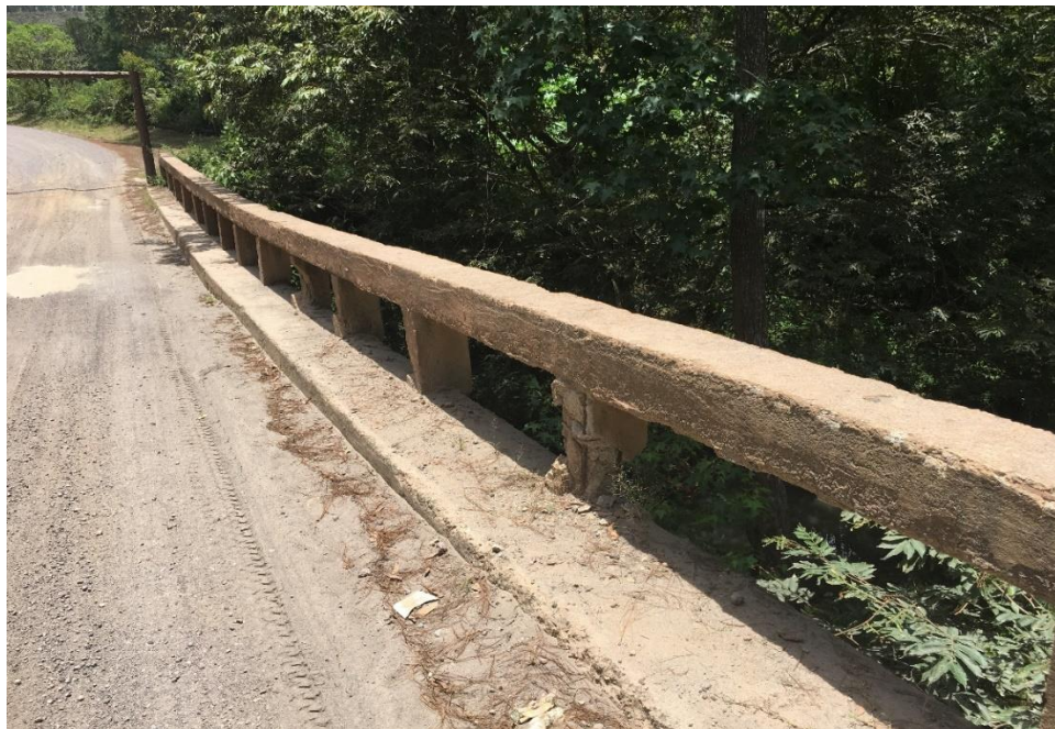
Vista del pretel en mal estado, a demoler
