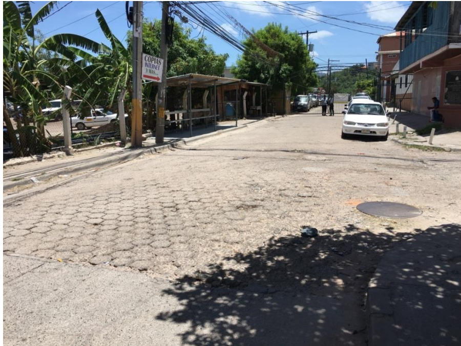
Inicio de tramo al que se le desmontará el adoquín y se pavimentará con concreto hidráulico
