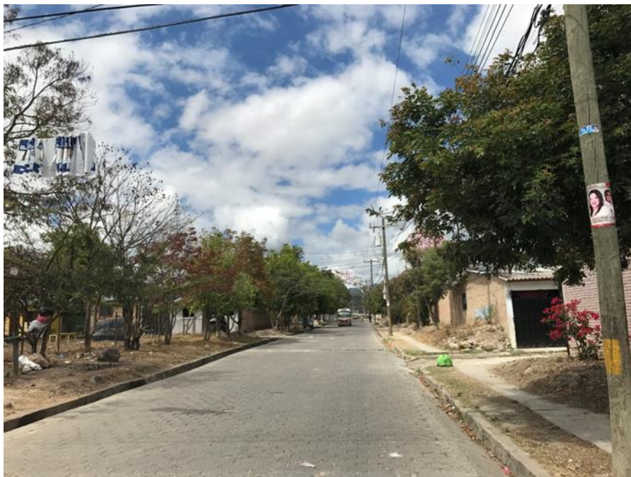
VISTA DEL ESTADO DE LOS ADOQUINES EXISTENTES
