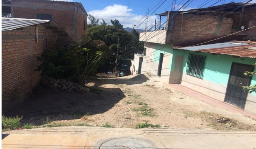
No. 1 VISTA DE CALLE 1: INICIO DE CALLE, SE OBSERVA EL MATERIAL GRANULAR EXISTENTE. ASI COMO EL EMPALME ENTRE EL CONCRETO EXISTENTE Y LA PROPUESTA DE PAVIMENTACION.
