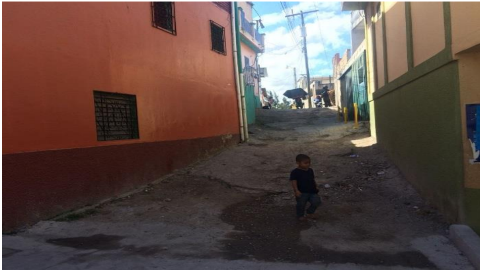
No. 2 VISTA DE TRAMO INTERMEDIO CALLE 1, SE OBSERVA EL MATERIAL GRANULAR EXISTENTE SE PROPONE LA CONSTRUCCION DE PAVIMENTO DE 0.12 m.
