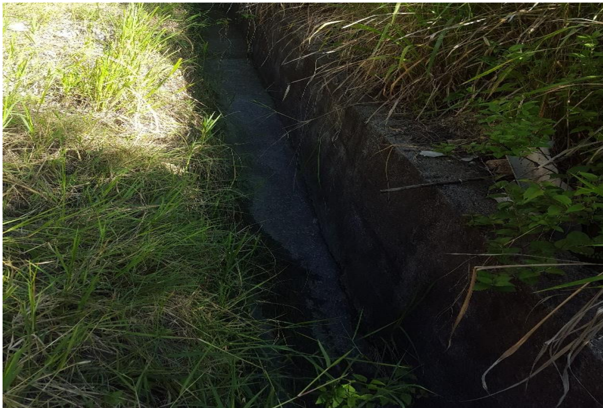
Panorama de cuneta a reparar
