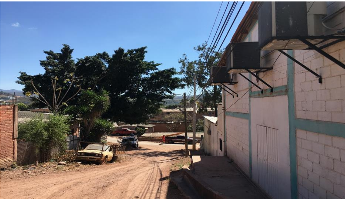
PANORAMA DE LA CALLE QUE REQUIERE PAVIMENTACION
