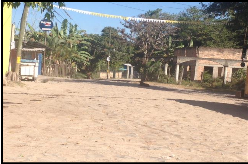
Vista del mal estado del empedrado existente
