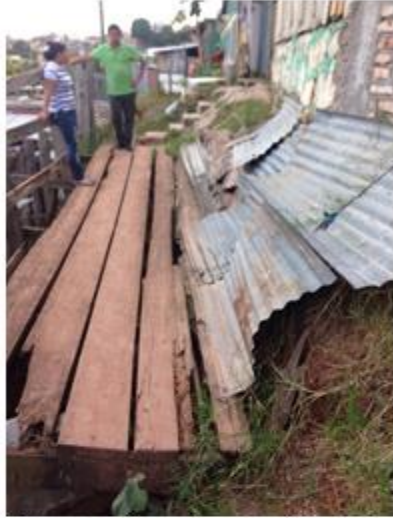
Estructura de madera instalada por la comunidad y usada para contener el terreno en la colonia 3 De Mayo.
