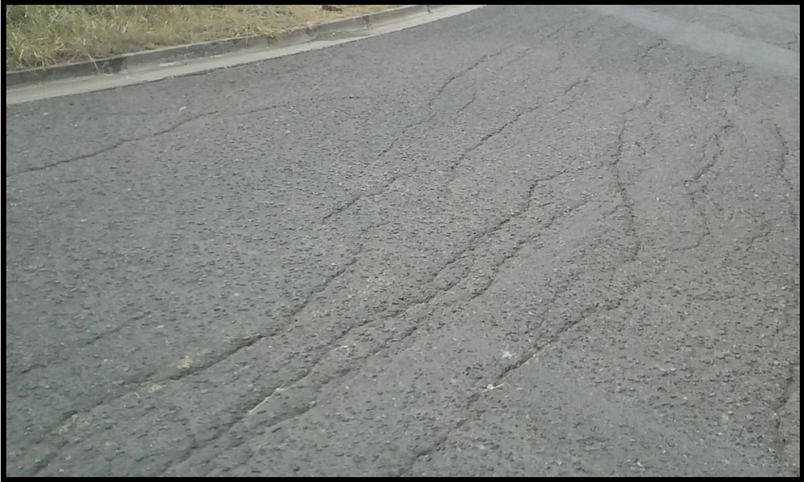
Vista del deterioro de la calle existente
