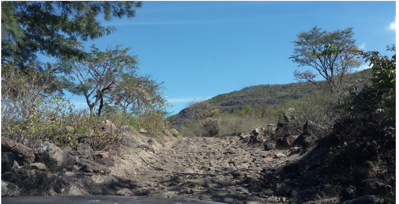
VISTA DE CALLE QUE REQUIERE BALASTADO
