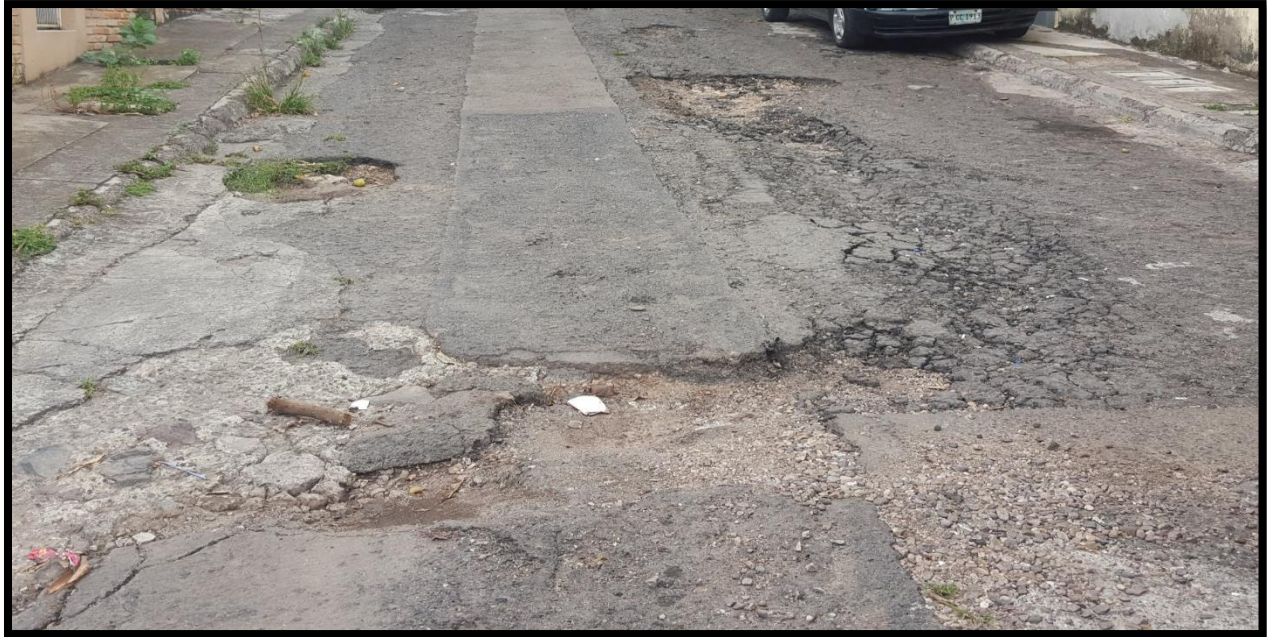
VISTA PANORAMICA DEL TRAMO EN MAL ESTADO
