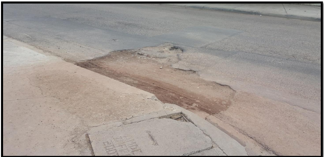
VISTA DEL MAL ESTADO DE LA ESTRUCTURA EXISTENTE
