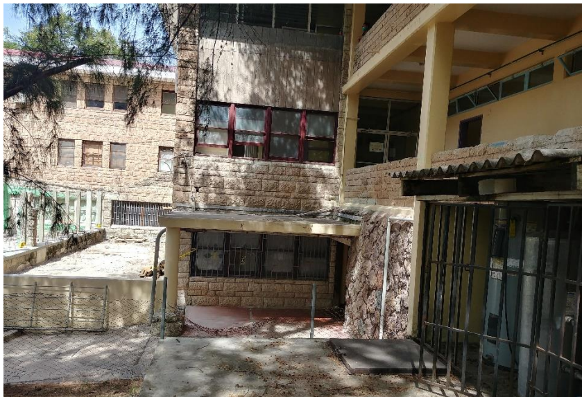
Vista de losa de concreto donde se instalará el tanque de agua de 1750 litros
