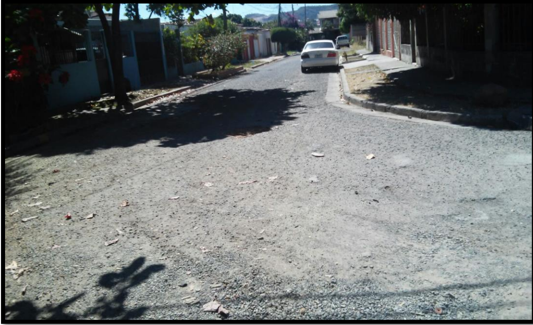
FALLA EN EL PAVIMENTO EN MEDIO DE LA CALLE
