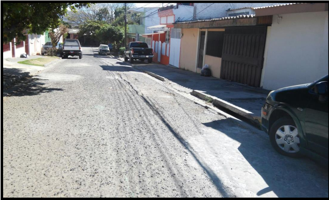
DETERIORO DEL PAVIMENTO A LO LARGO DE LA CALLE
