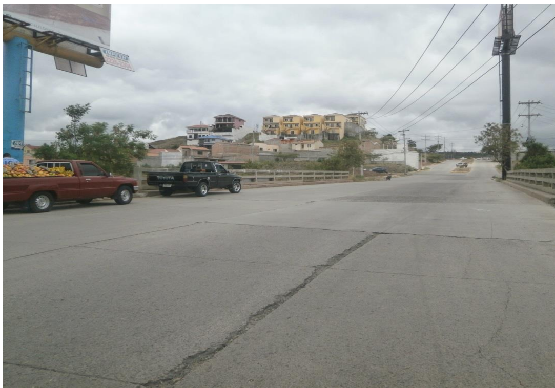
VISTA DEL ESTADO DE APROXIMACION EN COL. LAS UVAS
