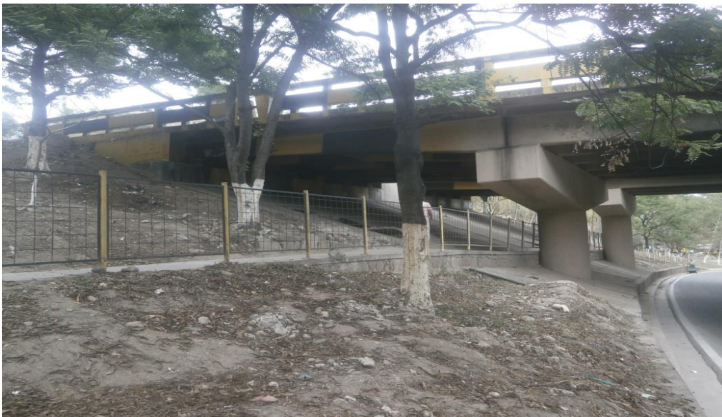
VISTA PANORAMICA DEL DAÑO EN PUENTE SAN FRANCISCO
