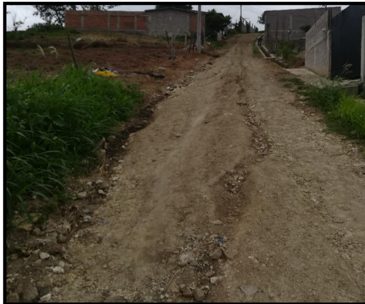
No.2 Vista de inicio de huellas vehiculares en calle No.3, se observa el deterioro de la calle.
