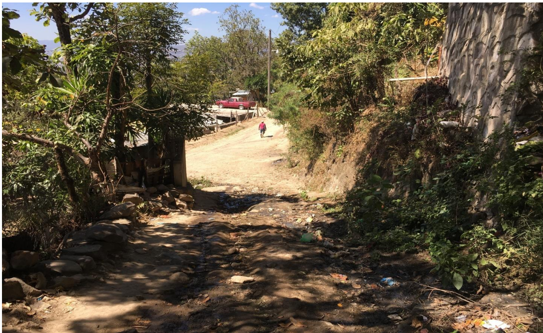
VISTA DEL MAL ESTADO DE LA CALLE
