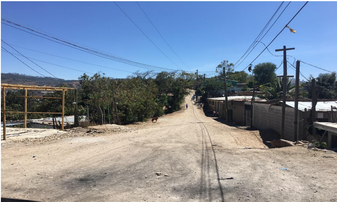
VISTA DE LA CALLE QUE REQUIERE BALASTADO
