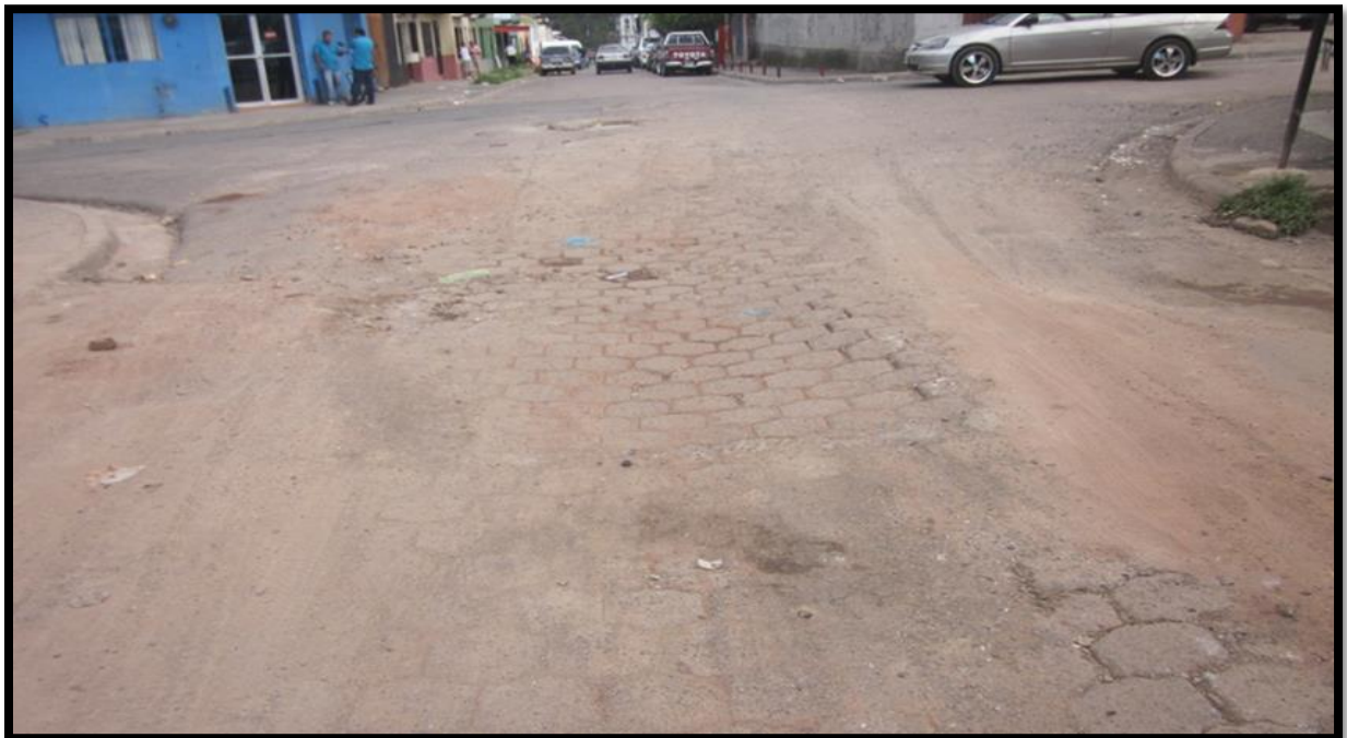
OTRA VISTA DEL MAL ESTADO EN QUE SE ENCUENTRA EL ADOQUINADO
