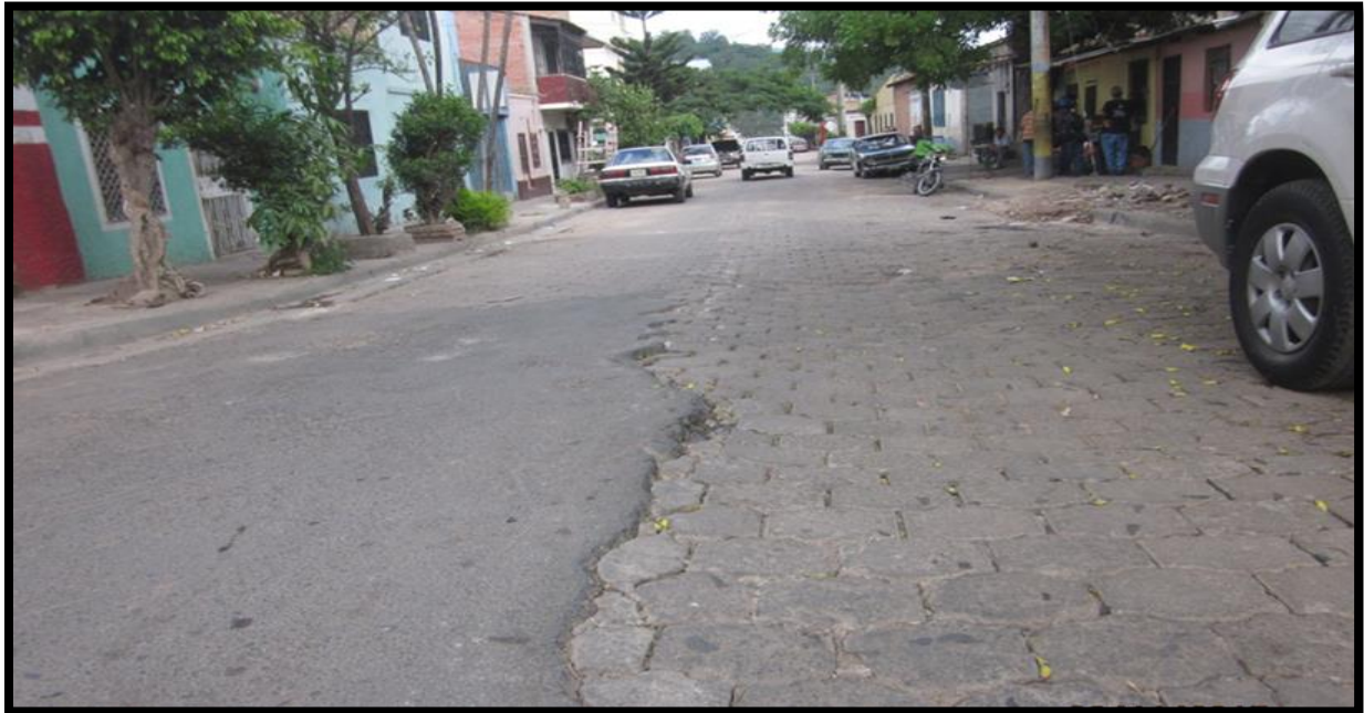
VISTA PANORAMICA DEL MAL ESTADO DE LAS CALLES
