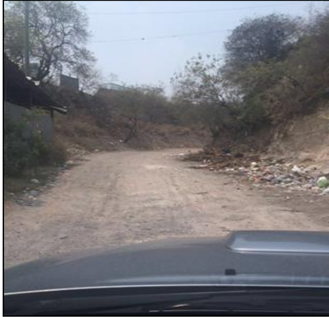
Tramo en mal estado de colonia El Álamo
