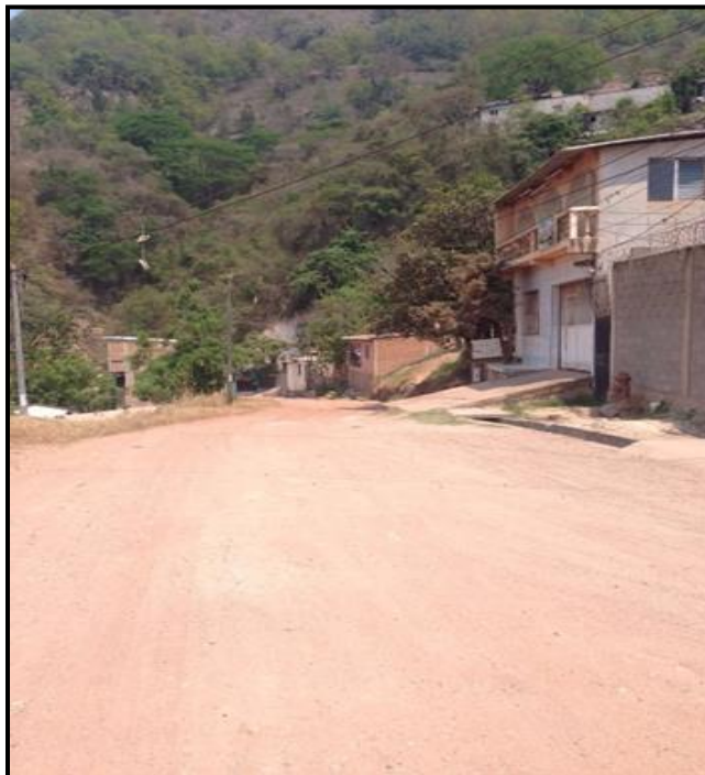
Panorama del tramo en mal estado
