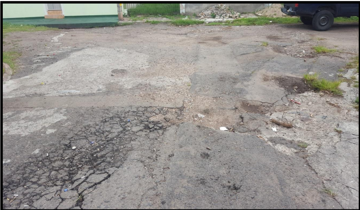
VISTA DEL MAL ESTADO DE LA ESTRUCTURA EXISTENTE
