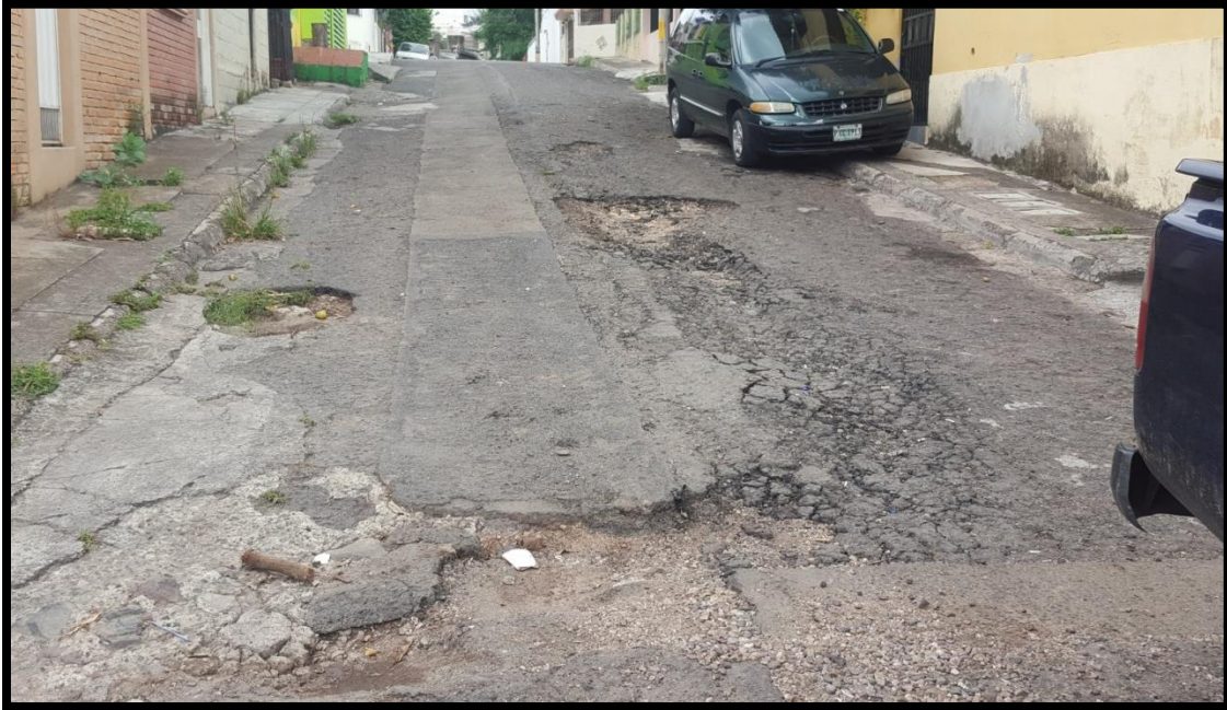
VISTA PANORAMICA DEL TRAMO EN MAL ESTADO
