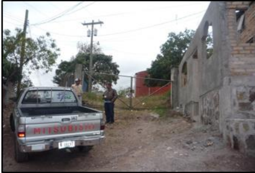
INICIO DE PROYECTO EN QUE SE INSTALARÁN LAS TUBERÍAS PARA EL AGUA POTABLE
