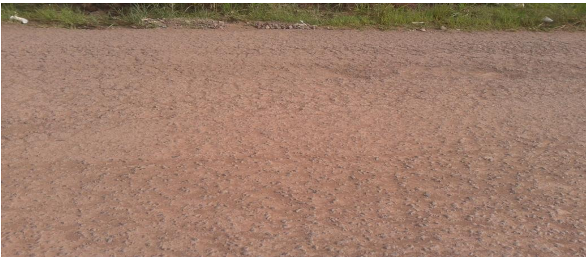
FOTO 4. PARTE HACIA LA UNAH EN LA CUAL SE INTERVENIRA PARTE DE CARPETA ASFALTICA MUY DETERIORADA
