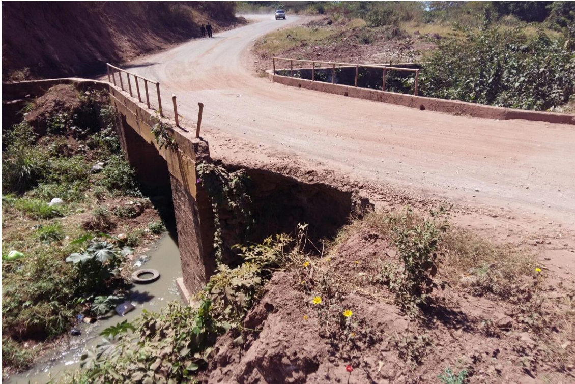
FOTO 3. VISTA DONDE SE CONSTRUIRA EL MURO DE MAMPOSTERIA PARA PROTECCION DE PUNTE EXISTENTE YA QUE SE APRECIA EL MAL ESTADO QUE SE ENCUENTRA POR EL DETERIORO DE LAS AGUAS LLUVIAS
