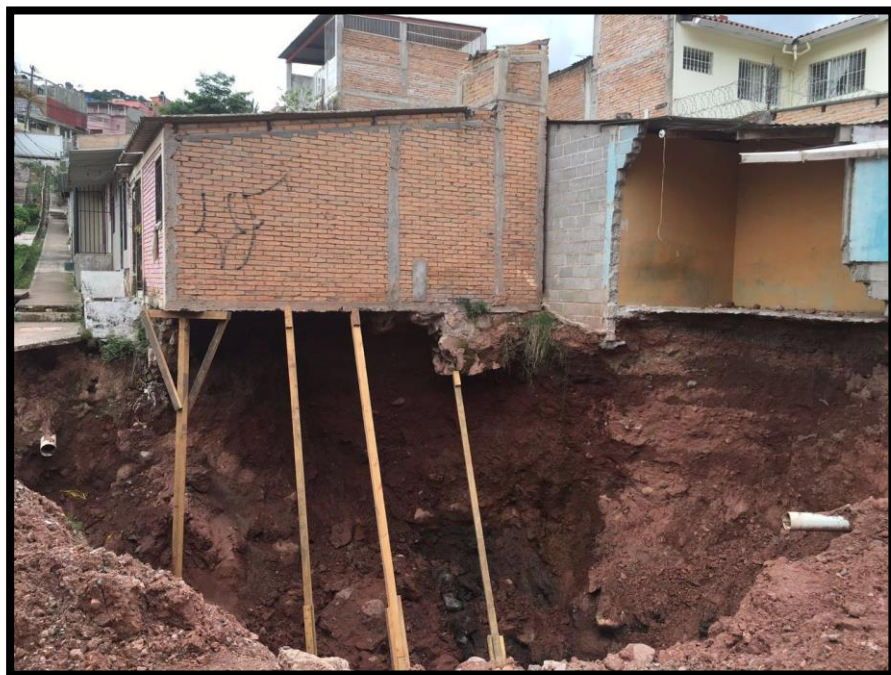
Panorama del daño en el terreno a causa de las intensas lluvias
