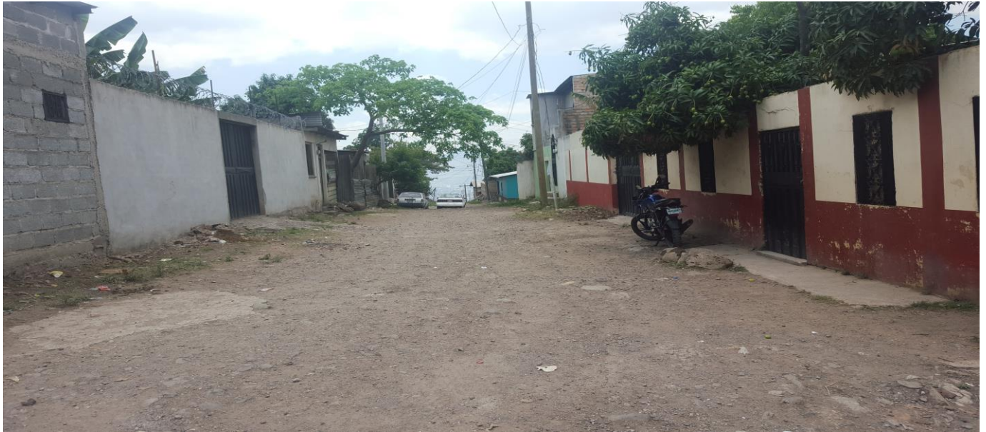
TRAMO A REPARAR EN ACCESO A COL. NUEVA DANLI
