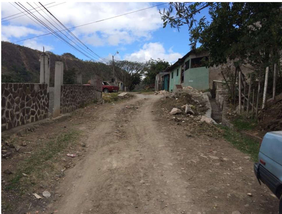
SE PUEDEN OBSERVAR LAS MALAS CONDICIONES EN QUE SE ENCUENTRA LA CALLE ACTUALMENTE
