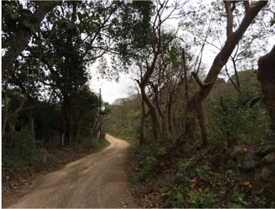
CALLE A REPARAR
