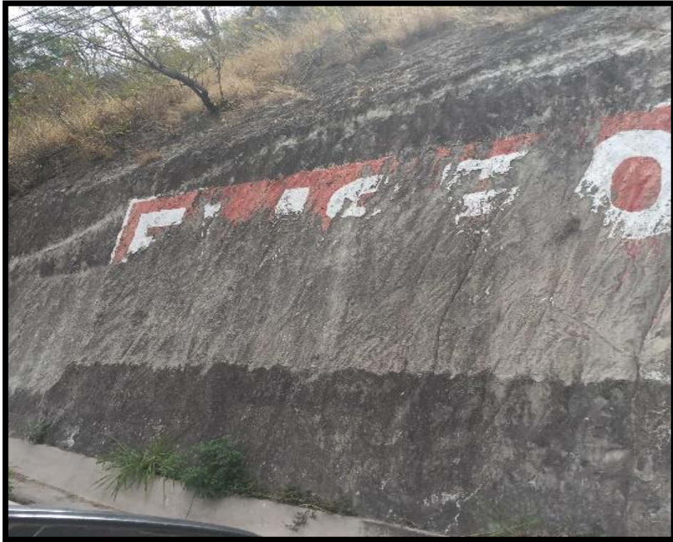
OTRA VISTA DE LAS MANCHAS EN LAS SALIDAS DEL DISTRITO
