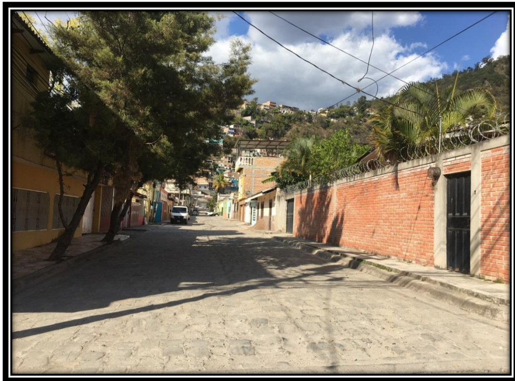
Foto No. 2: Estado actual del empedrado
