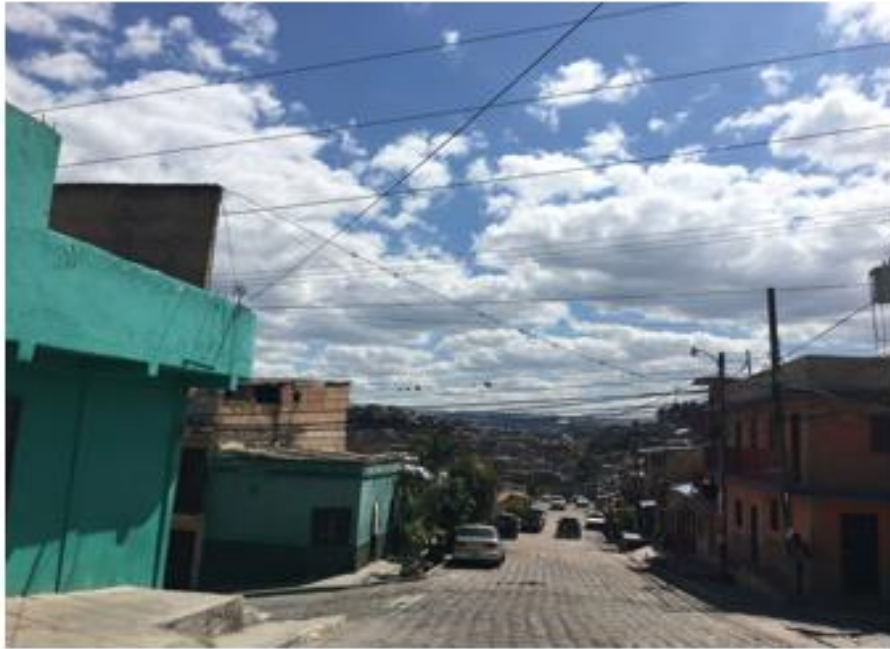
SE PUEDE OBSERVAR EL DETERIORO DEL EMPEDRADO EXISTENTE.
