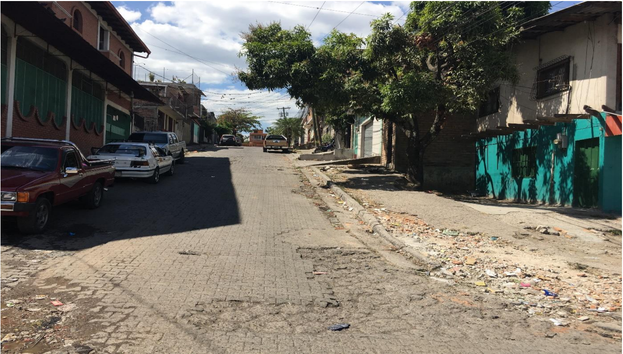
SE OBSERVA EL MAL ESTADO DEL ADOQUINADO
