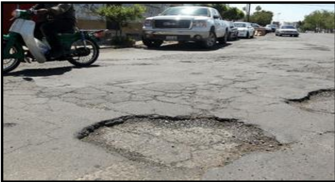
Otra vista panorámica del tramo en mal estado
