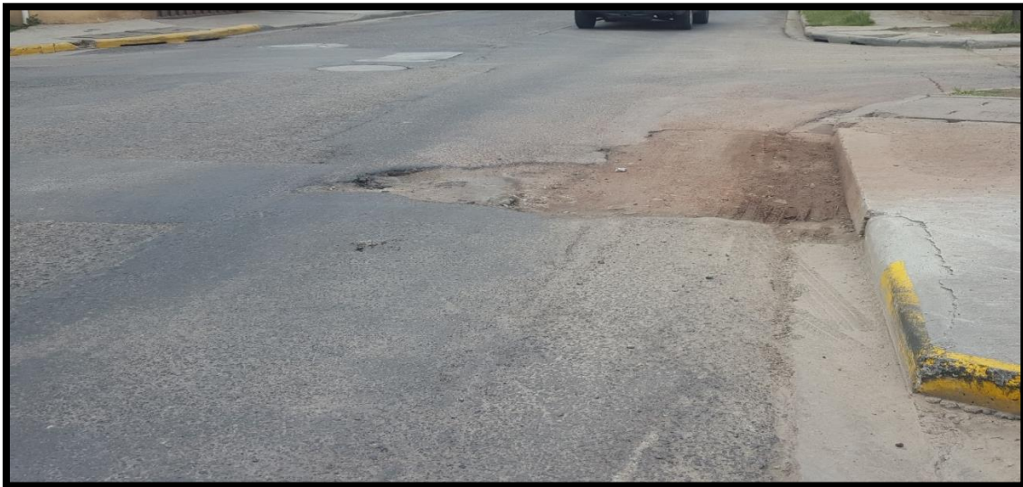
Vista del mal estado de la superficie de rodadura
