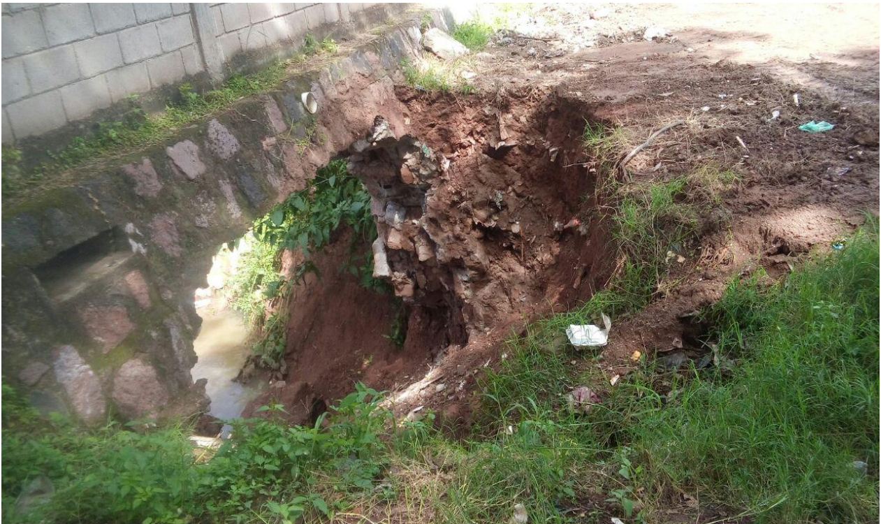
SITUACION ACTUAL DEL MURO
