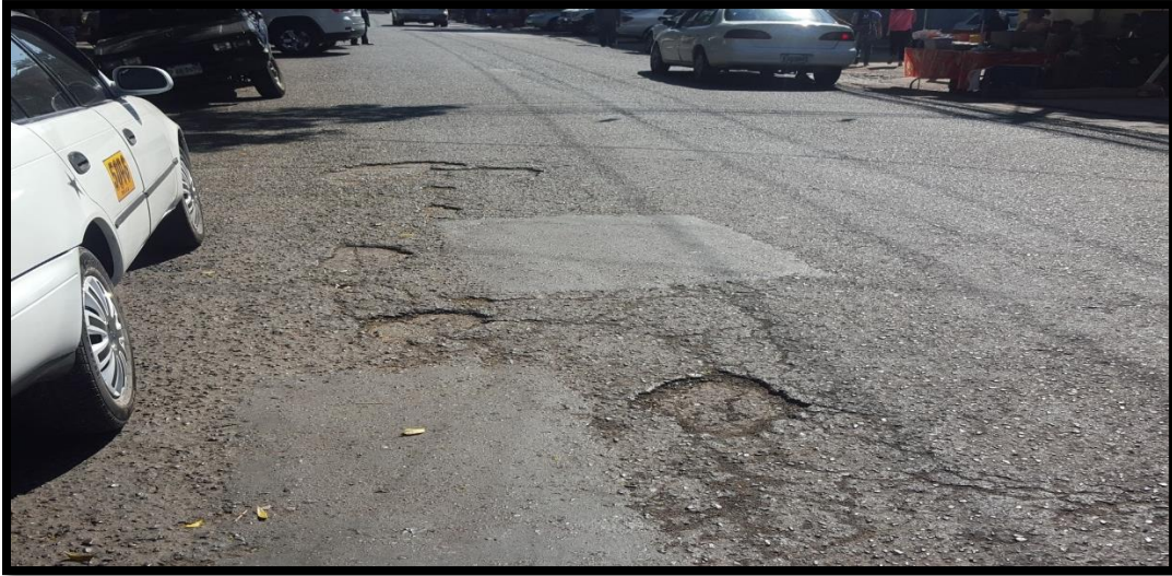
Vista del mal estado de la superficie de rodadura
