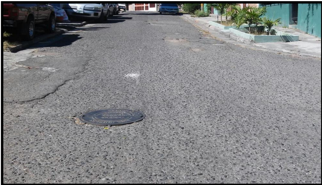
Otra vista panorámica del tramo en mal estado
