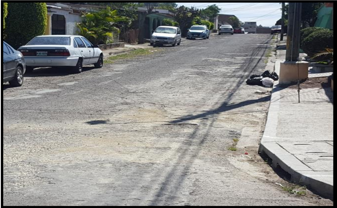
Vista del deterioro de las calles
