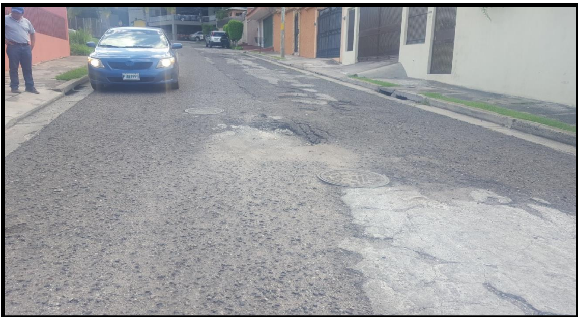
Vista del Mal estado en Col. El Triangulo
