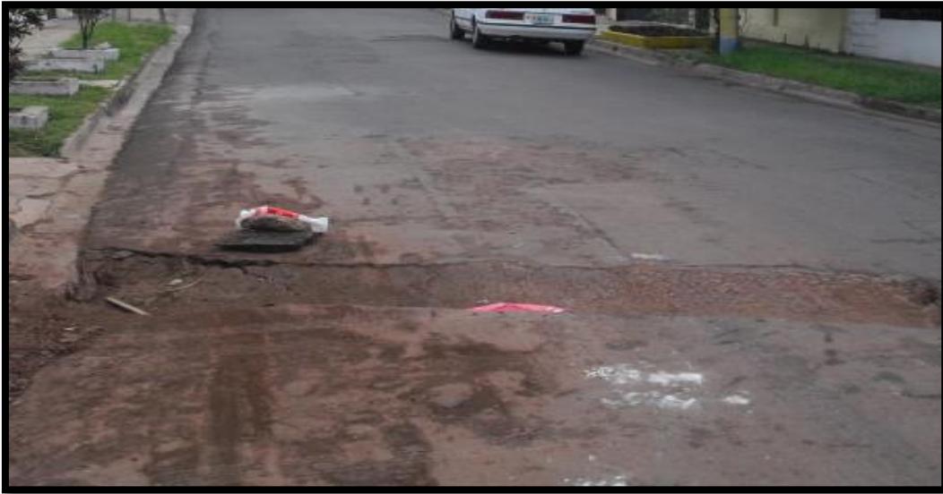
Falla en el pavimento en medio de la calle.
