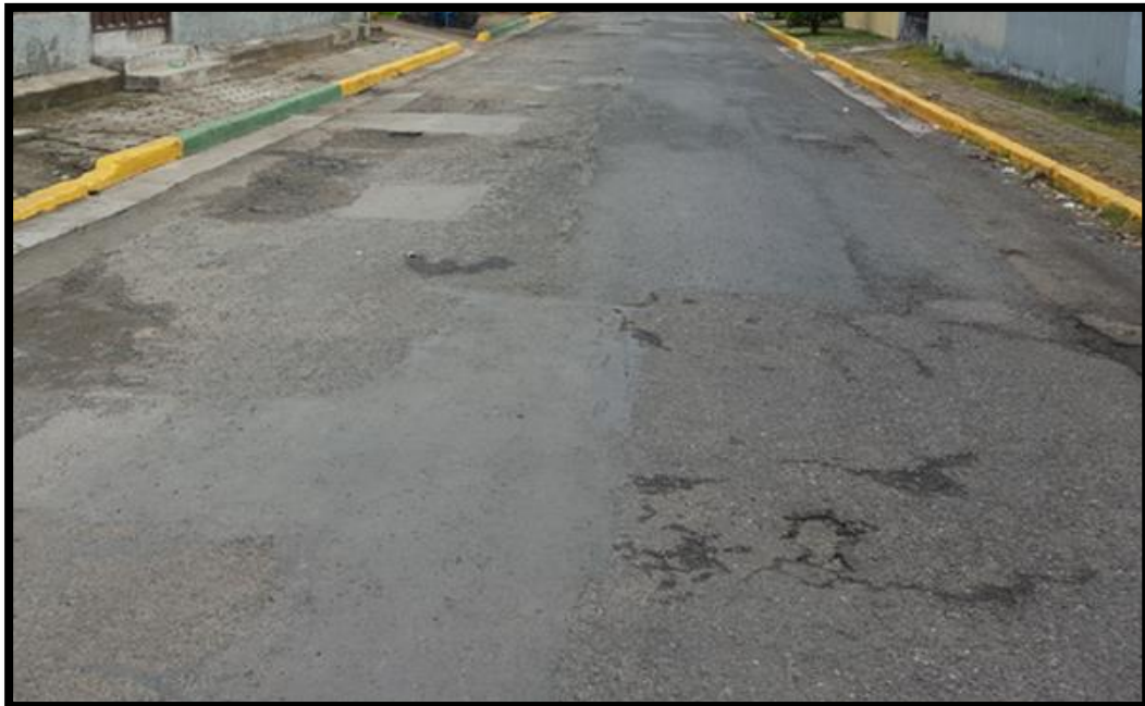
Perspectiva de grietas en medio de la calle.
