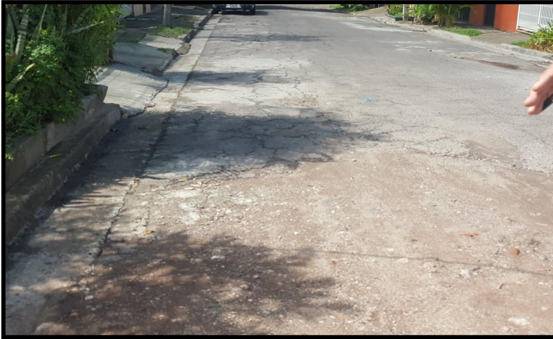
Vista del mal estado de la carpeta de asfalto
