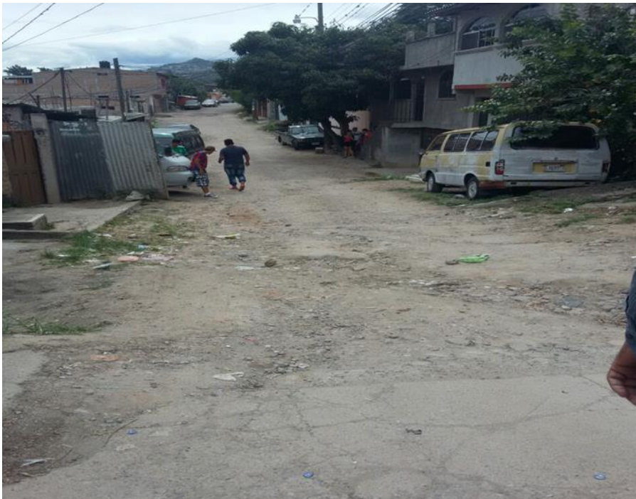
Foto No. 2: Estado actual de la calle de terracería
