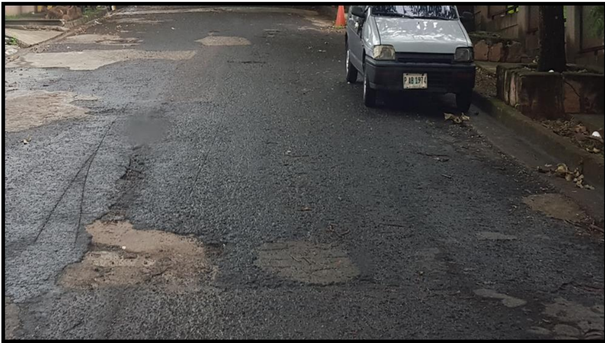
Vista del tramo en mal estado de las calles
