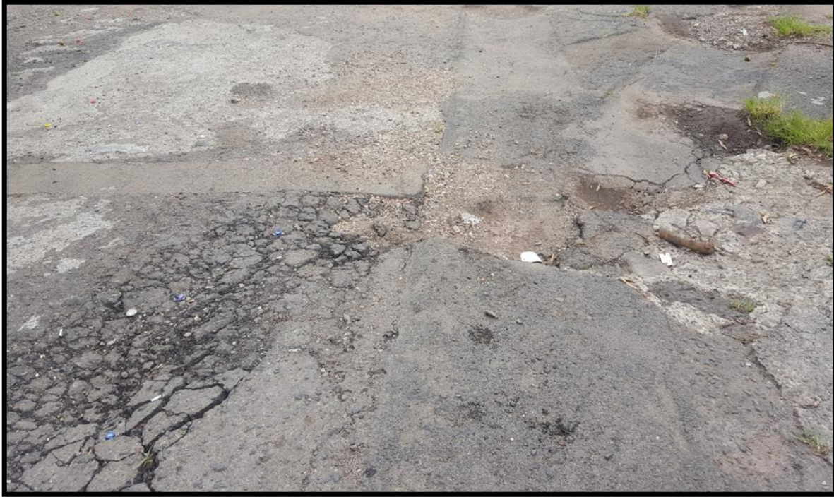
Vista del deterioro de la calle existente
