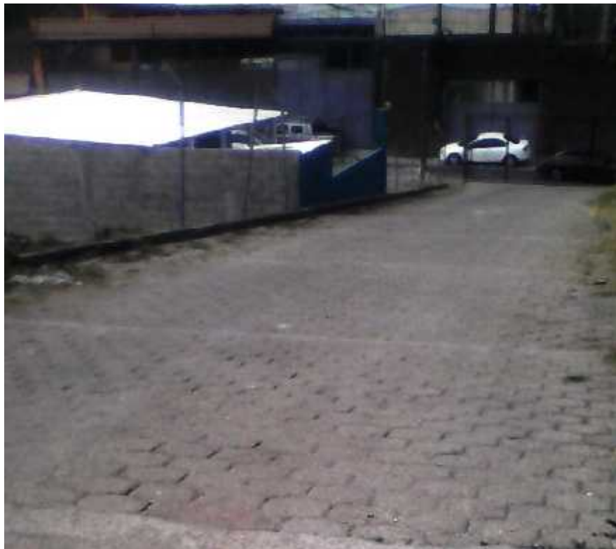
Calle adoquinada en mal estado
