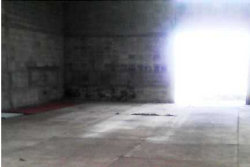
Vista panorámica del área del piso deteriorado
