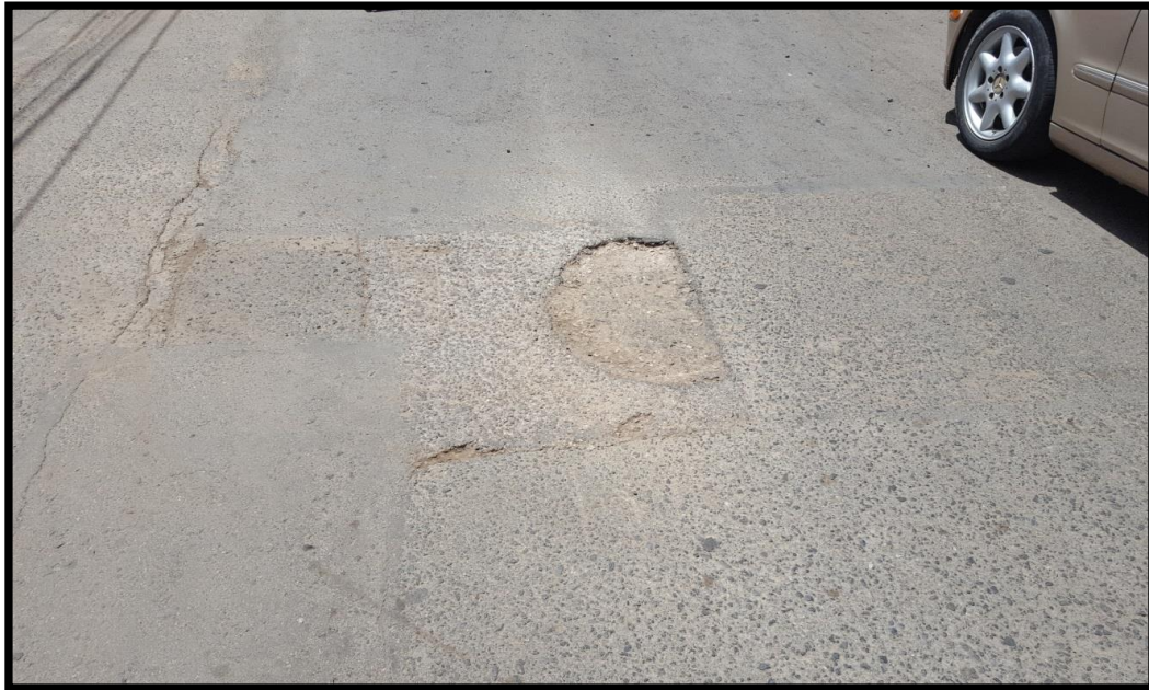
VISTA DEL TRAMO EN MAL ESTADO DE LAS CALLES
