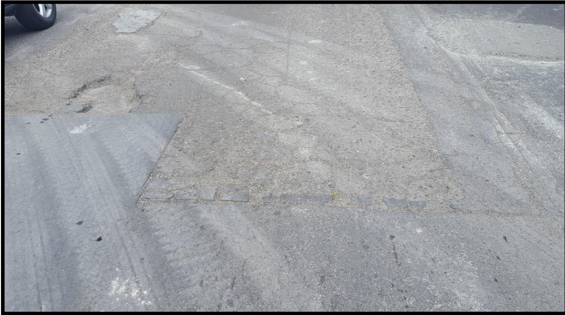
Imagen del mal estado de la calle en la actualidad
