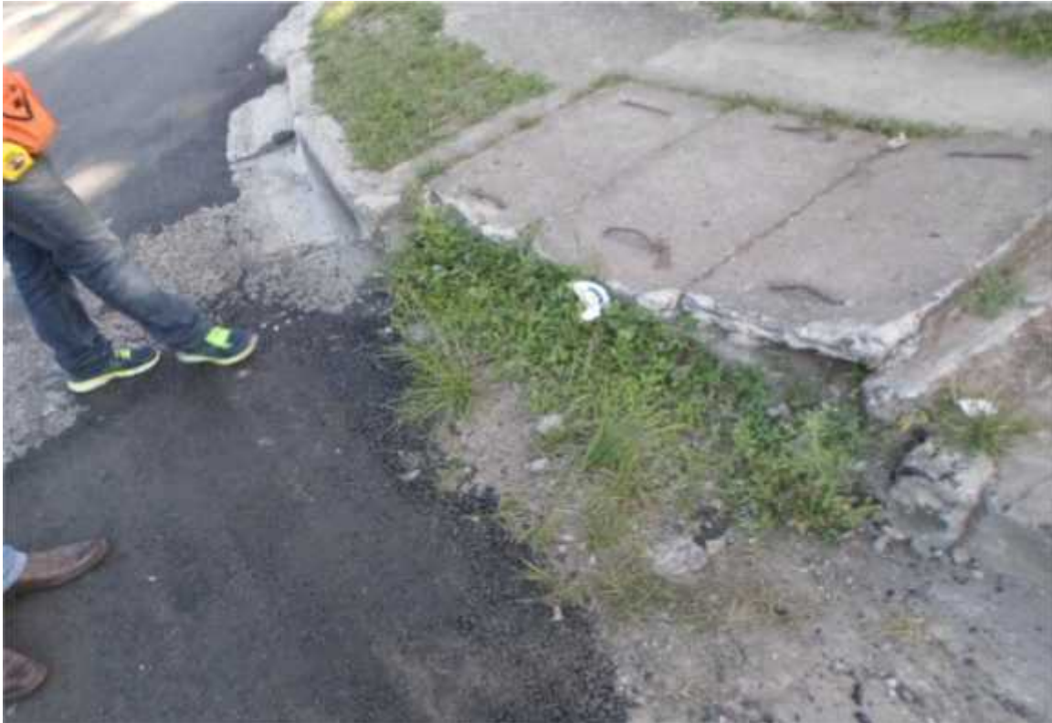
TRAMO A REHABILITAR 2DA ENTRADA COL. LOARQUE
