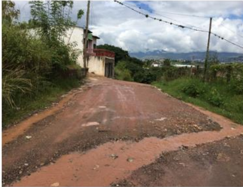
ESCORRENTIA SUPERFICIAL QUE HA DAÑADO LA CALLE
