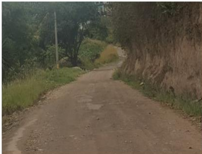
SE OBSERVAN LAS MALAS CONDICIONES DE UN TRAMO DE LA CALLE A PAVIMENTAR
