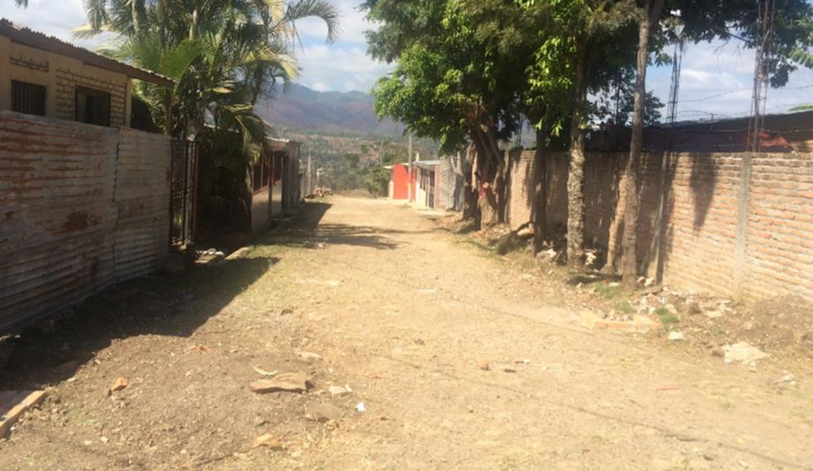
Foto 3. Se aprecia la condición actual de la calle en el tramo central de col nuevo sacramento por lo que es importante realizar el balastado.
