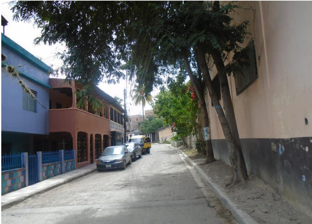
INICIO DE CALLE A PAVIMENTAR ACTUALMENTE ADOQUINADA EN MAL ESTADO
