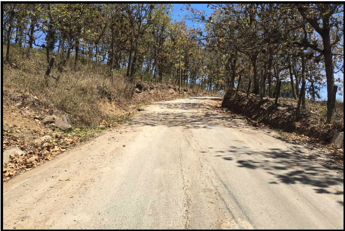
Acceso a col. Maria José en mal estado
