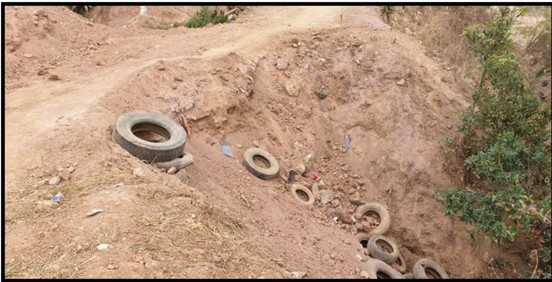
No.2 Ubicación de muros de gaviones, se observa deslizamiento del suelo.
