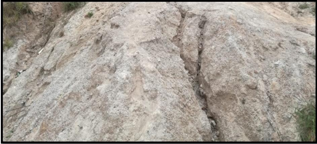
No.1 Vista del suelo erosionado por las escorrentías superficiales.
