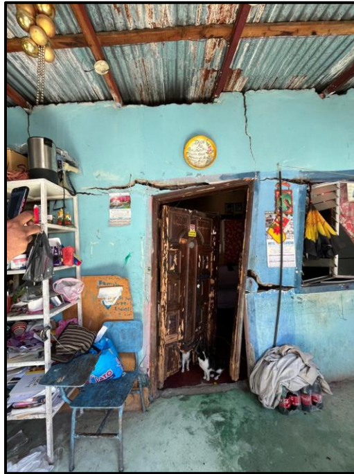
Ilustración 4. Una de las viviendas con mayor afectación en la Col Ulloa por el deslizamiento.
