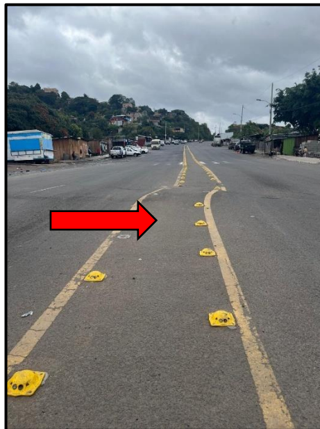
Ilustración 7. Desplazamiento en la línea Central del anillo periférico por los movimientos del deslizamiento
