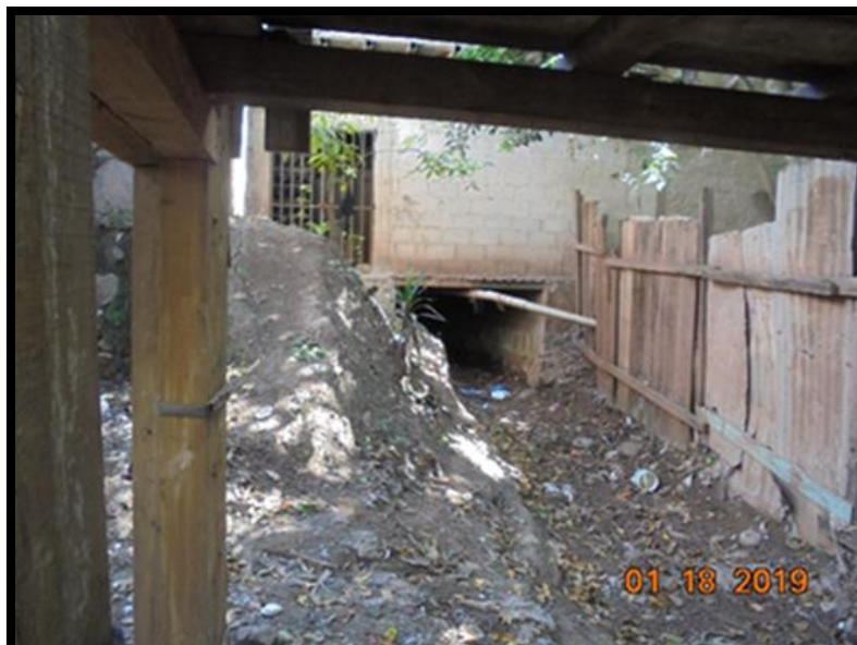
Ilustración 2 Estrangulamiento del cauce de la quebrada por los pobladores de la zona.
