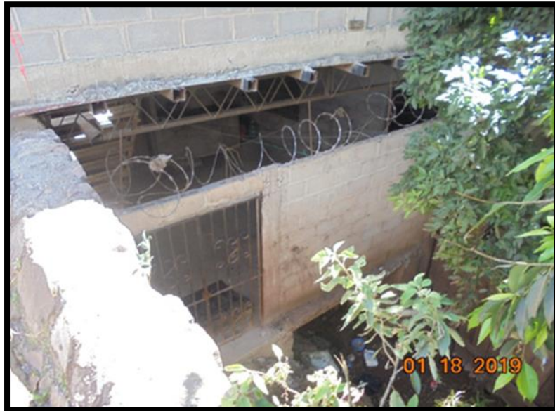
Ilustración 1 Edificación sobre cauce de quebrada que obstaculiza el flujo natural de la misma.
