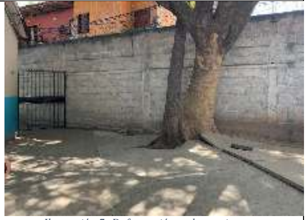
Ilustración 7: Deformación en losa existente.
