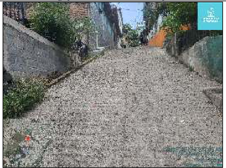
Fotografía 6: Estado de cuneta en callejón 6.
