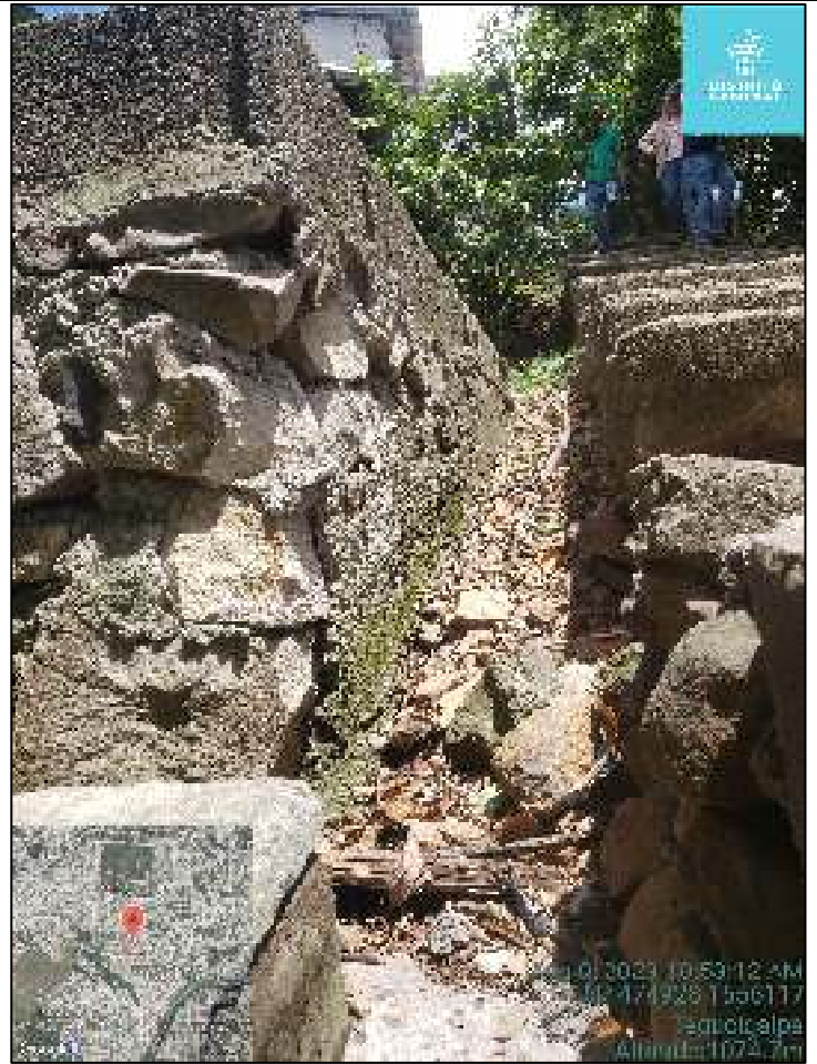
Fotografía 8: Estado de cuneta en callejón 8.
