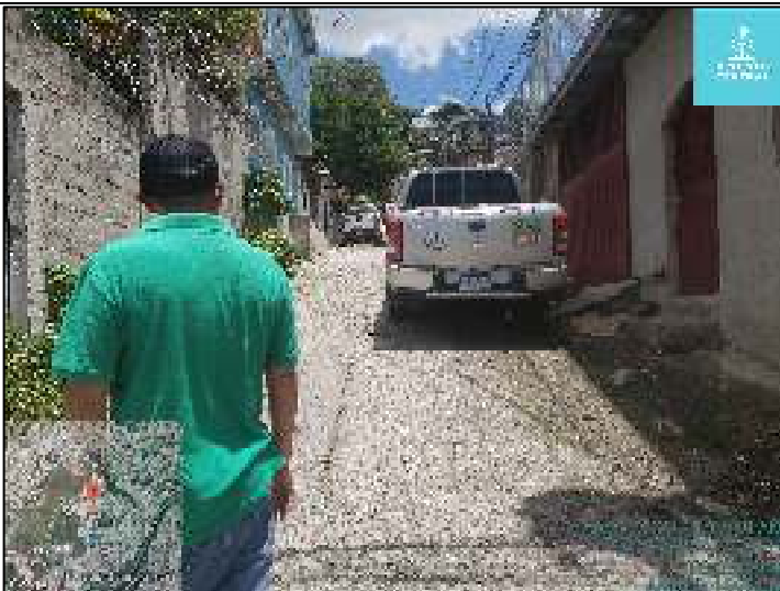
Fotografía 5: Estado de cuneta en callejón 5.
