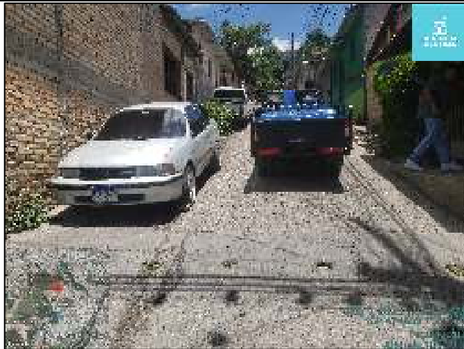
Fotografía 3: Estado de cuneta en callejón 3.
