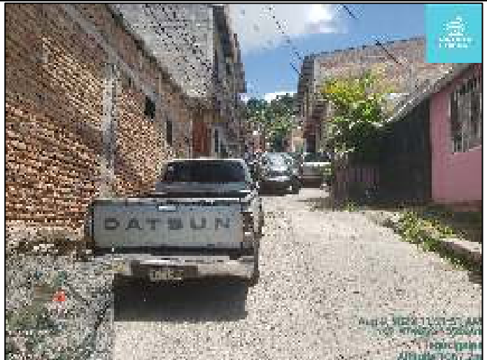
Fotografía 4: Estado de cuneta en callejón 4.
