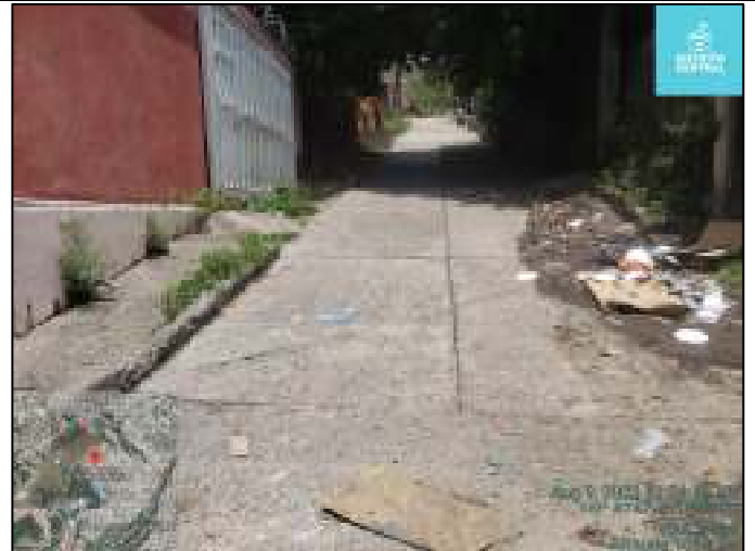
Fotografía 2: Estado de cuneta en callejón 2.
