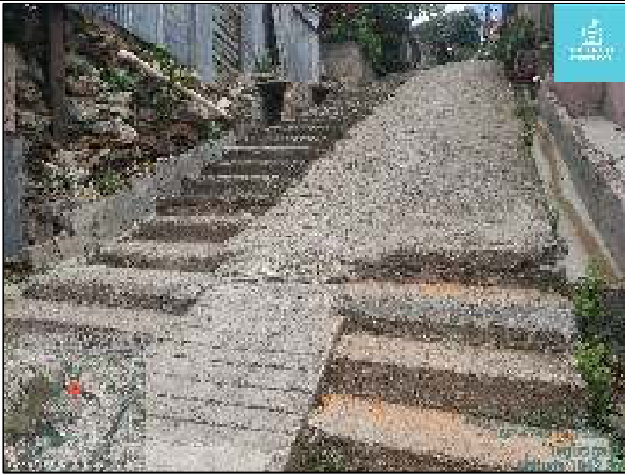
Fotografía 7: Estado de cuneta en callejón 7.
