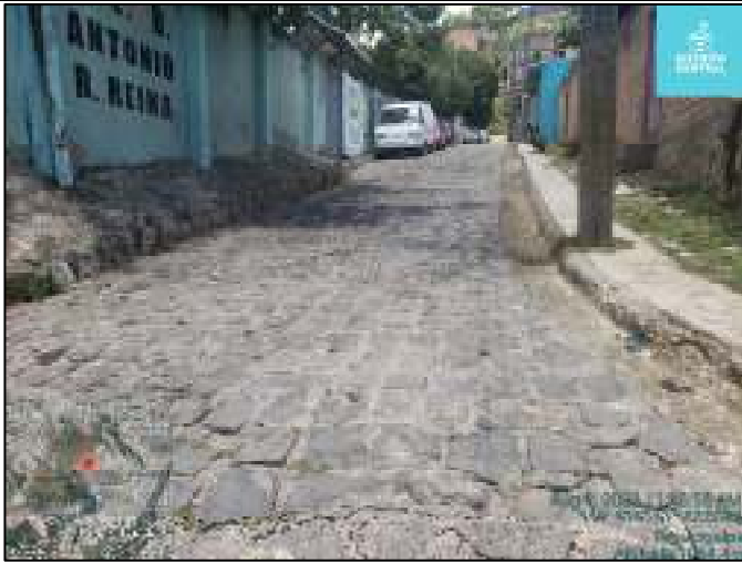
Fotografía 1: Estado de cuneta en callejón 1.
