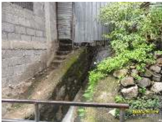
Ilustración 3. Condiciones existentes de drenaje
