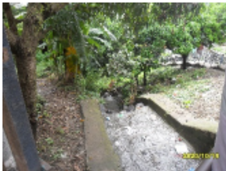
Ilustración 1. Condiciones existentes de drenaje.
