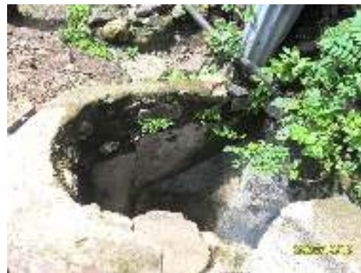
Ilustración 4. Condiciones existentes de drenaje
